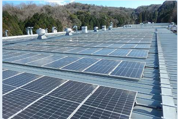
東海化成工業（第二工場）
