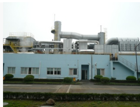
燃焼式VOC処理装置 東海橡塑(嘉興)有限公司(中国)
