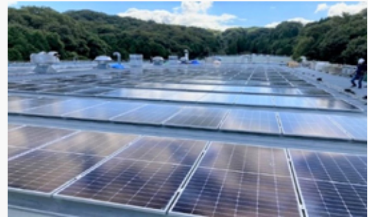
新設した太陽光パネル 東海化成工業株式会社
