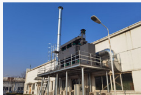
燃焼式加硫ガス処理装置 東海橡塑模具(天津)有限公司(中国)
