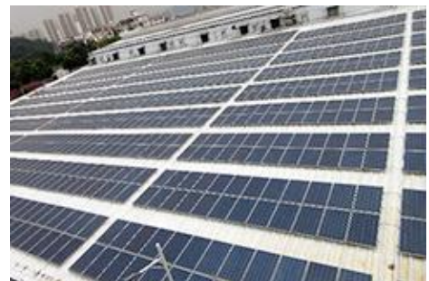
屋根に設置した太陽光パネル(中国TRG)
