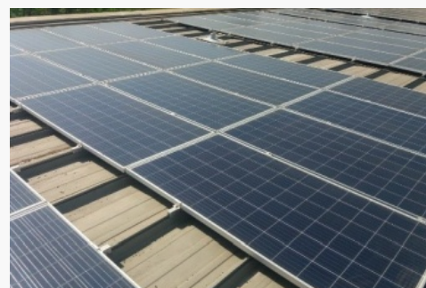
新設した太陽光パネル TRIN (インド)
