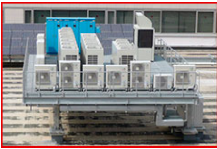
旧研究本館屋上の室外機
